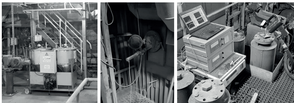
Rys. 9. Układ zasilania w modyfikator spalania (po lewej); sonda optyczna Politechniki Śląskiej (po środku); analizatory spalin Instytutu Energetyki (po prawej) podczas badań na kotle OP-430 w EC Siekierki.
